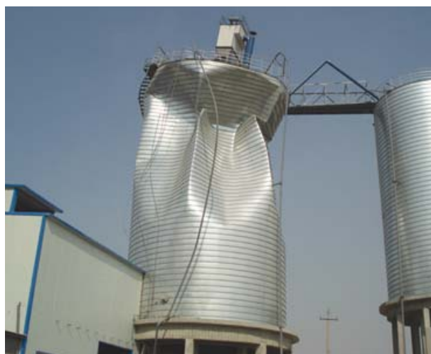
Rysunek 1.6. Zniszczenie silosu spowodowane wystąpieniem podciśnienia ( http://www.silosupplier.com/how-to-prevent-steel-silo-collapse/ )
